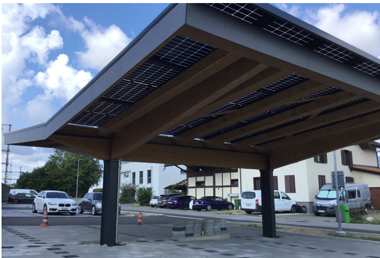
Solarcarport auf Krinner Schraubfundamenten
