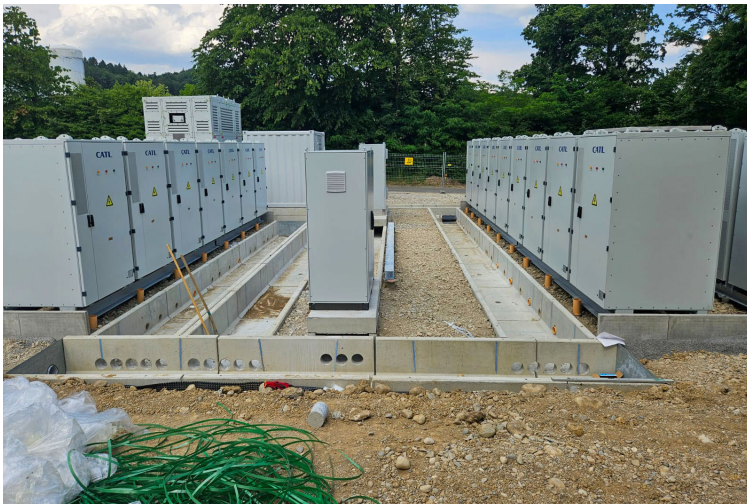
Batteriespeicher fundiert auf Krinner Schraubfundamenten
