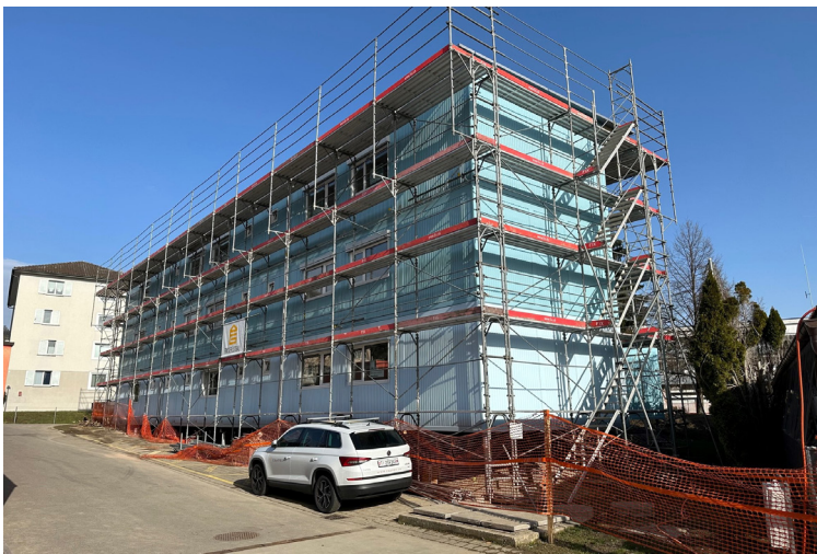
3-geschossiger Modulbau mit Hangausgleich
